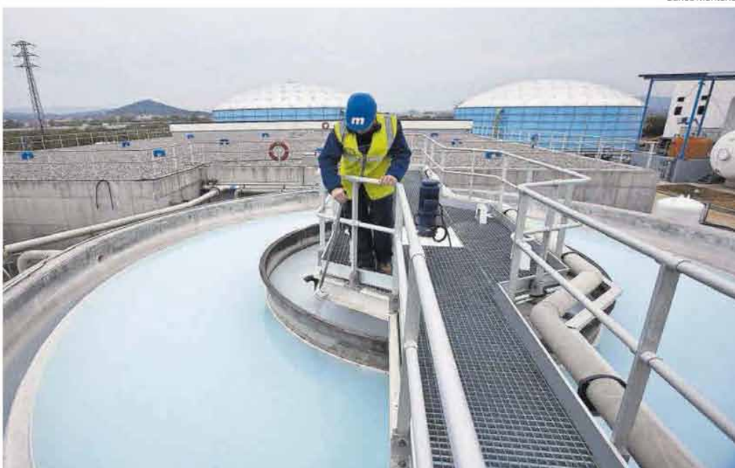
Planta desalinizadora del Tordera, en Blanes.
