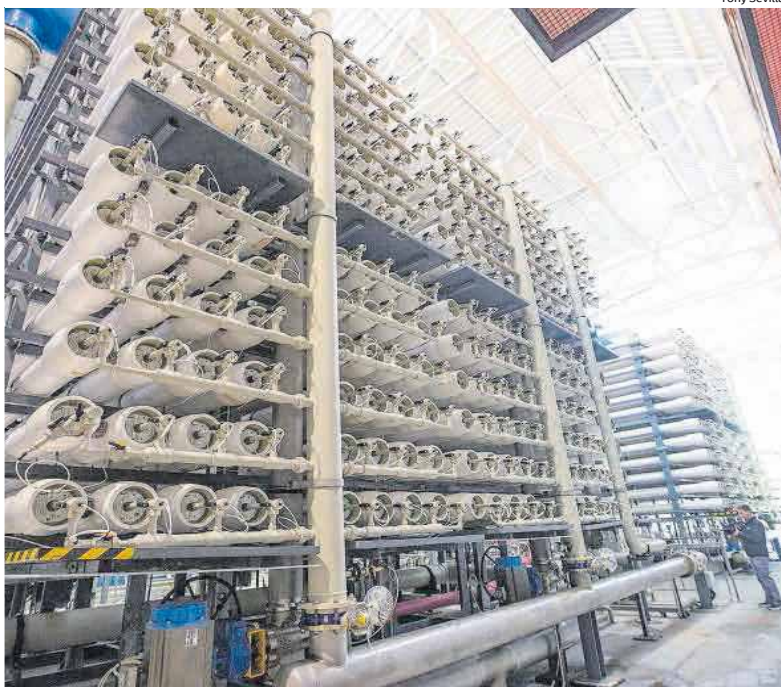
Interior de la planta desaladora de Torrevieja.
